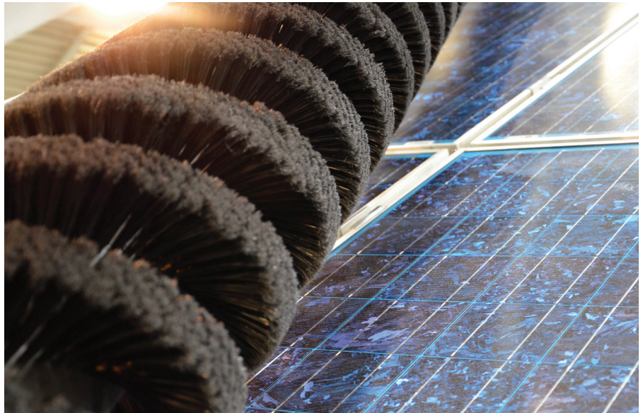
Abb. 6: Reinigung einer PV-Anlage mit einer Bürstenwalze
