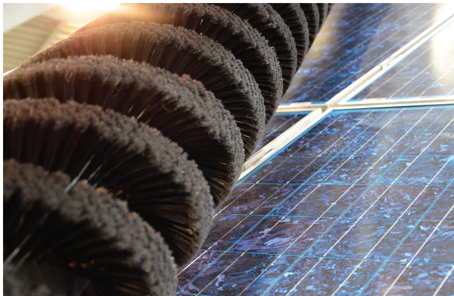
Abb. 6: Reinigung einer PV-Anlage mit einer Bürstenwalze
