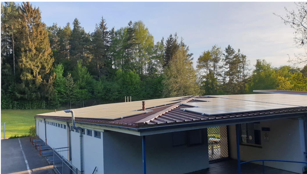
PV-Anlage auf dem Freibad Beratzhausen
