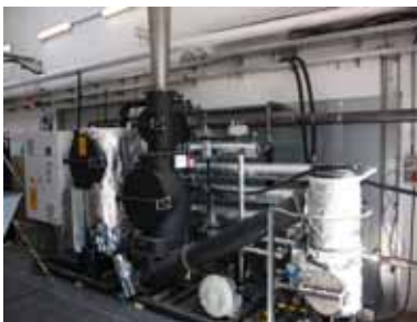
Holzvergaseranlage, Spanner Re 2 GmbH
