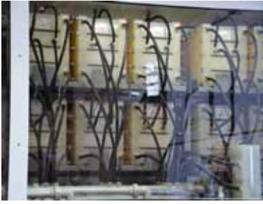
Redox-Flow-Zelle im Fraunhofer Institut ICT
