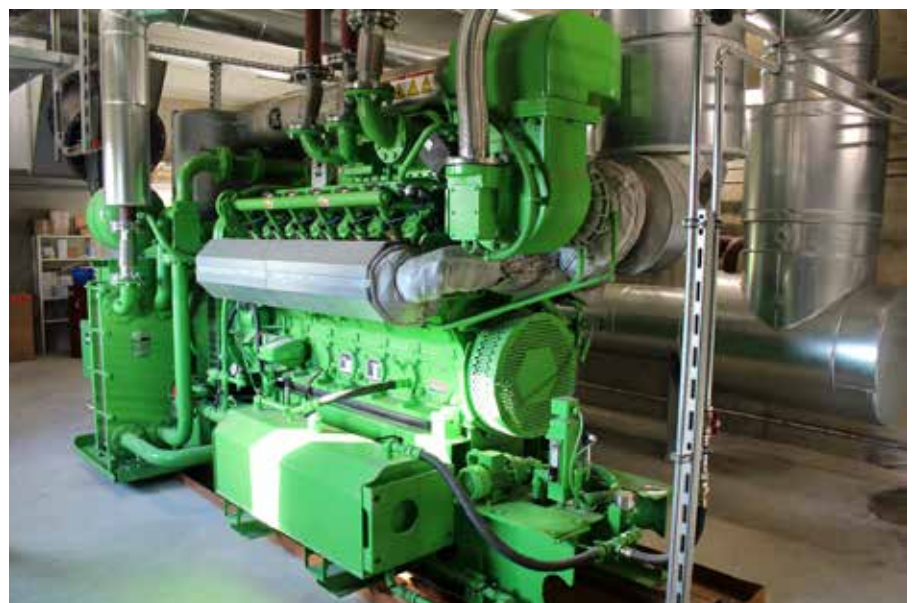
Abbildung 2: BHKW einer Biogasanlage (537 kW e )
