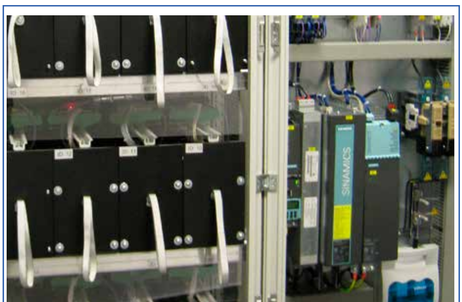
Abb. 6: Innenleben eines Speichersystems
