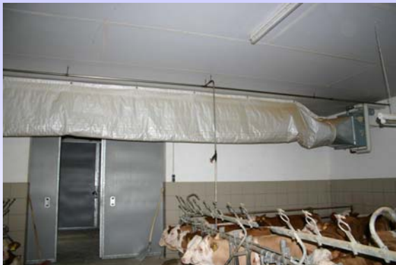
Heizung über Luftanwärmung
