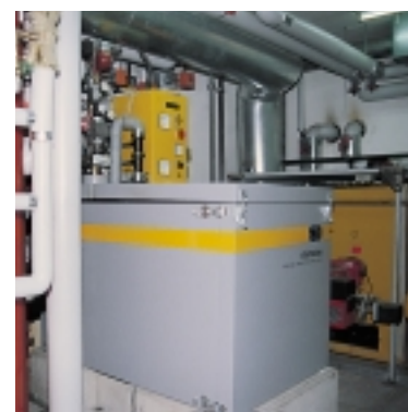
BHKW mit Pufferspeicher
