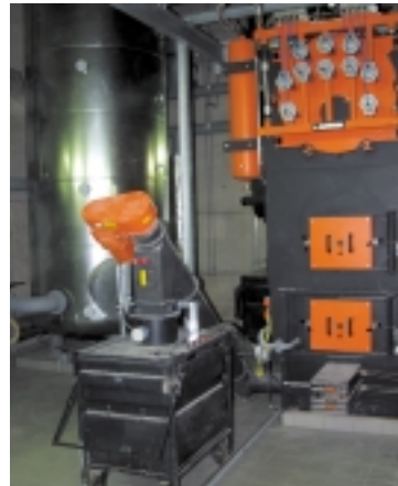
Kleiner Biomassekessel mit Ascheaustragung und Pufferspeicher
