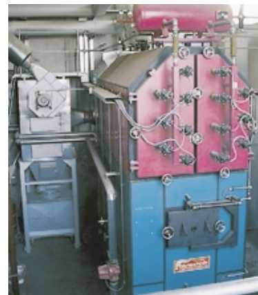
Blick in den Heizraum mit Biomassekessel und Rauchgasreinigung
