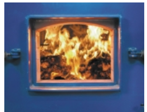
Blick in das Kesselinnere
